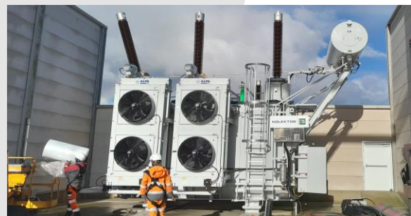
Transformateur de puissance de sous-station électrique 70 MVA – 225 kV, ENEDIS, FRANCE
