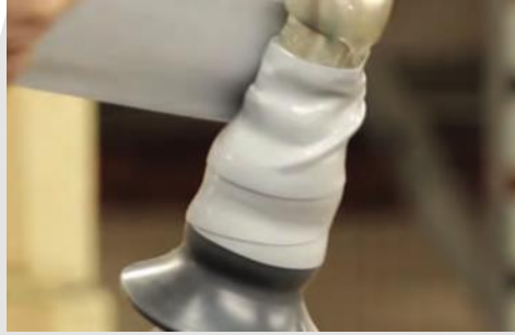
2 Effectuez un second tour pour une isolation de 35 kV
