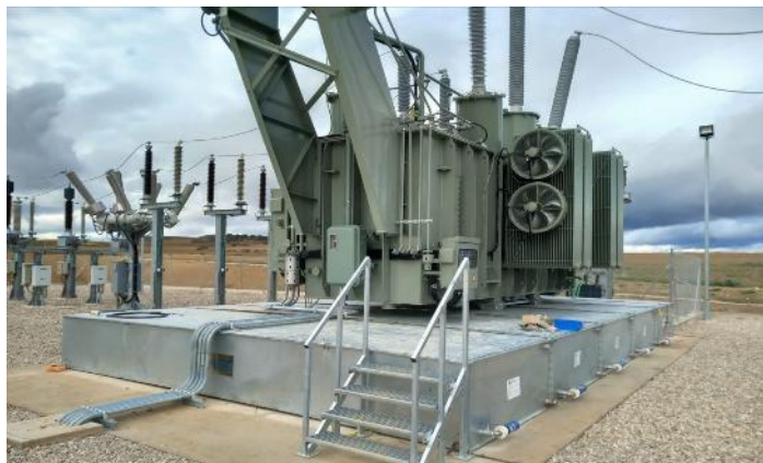
Vasca di ritenzione antincendio modulare ERT-MODULO 5 con scale di accesso e cartucce di filtrazione PETRO PIT-416 - REPSOL
