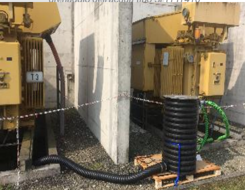
Bacino di contenimento in cemento per trasformatori di potenza, dotato di pompa di raccolta automatica e sistema di filtraggio PETRO BARRIER™
