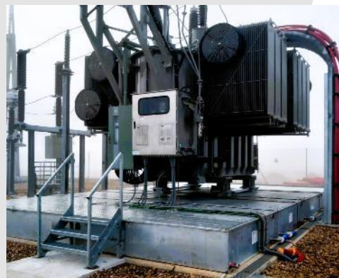
Trasformatore di potenza su SANERGRID TRT-MODULO 4, vasche di ritenzione dell'olio equipaggiate con filtri di drenaggio dell'acqua tipo SPI PIT416
