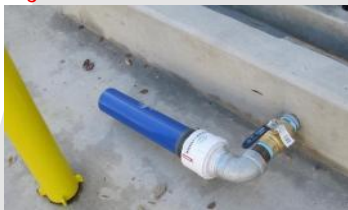
Filtro PETRO PIT 416 installato su un bund di ritenzione in calcestruzzo
