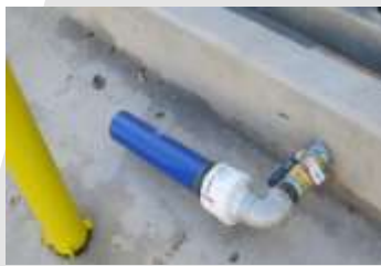
PETRO PIT 416 monté sur une fosse de rétention en béton
