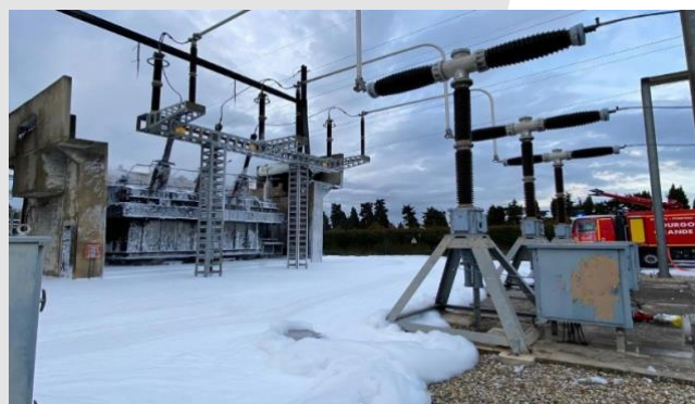
Résultat de l'aspersion par mousse et eau, et illustration du besoin de gestion des eaux d'extinction et des eaux pluviales.
