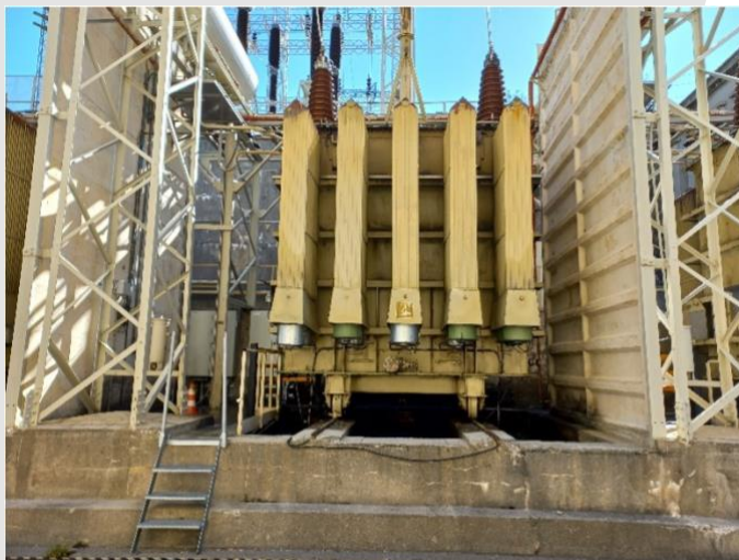
Transformateur sur fosse de rétention, non équipé de galets ni de couverture anti-feu EXTICOV®
