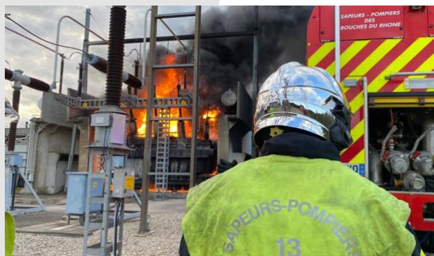
Arrivée des pompiers sur un feu de transformateur de puissance dans un poste électrique.
