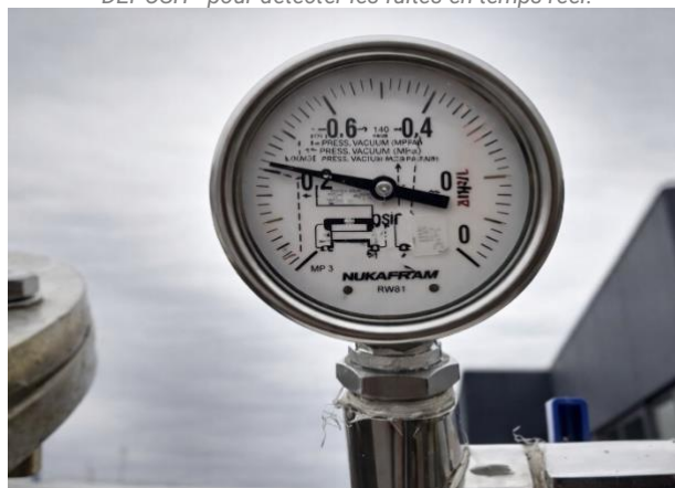
Vacuomètre de contrôle permettant la mesure et la surveillance de l'étanchéité de la fosse.
