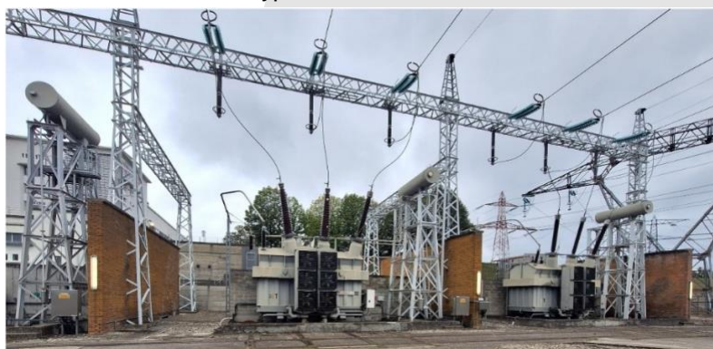
Exemple de plusieurs transformateurs avec fosses de récupération à galets qui envoient leurs huiles et leurs eaux de pluie vers une fosse déportée.
