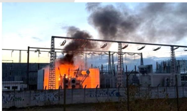
Exemple de feu de transformateur à huile avec confinement des hydrocarbures. Le diélectrique est très vite envoyé vers la fosse déportée et réduit le risque de propagation aux transformateurs voisins : réduction du risque de feu de piscine d'hydrocarbures.
