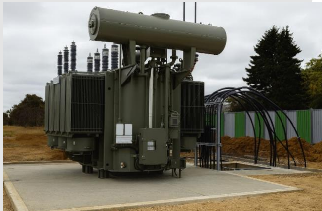
Exemple de sous-station avec transformateur sur bac de récupération en béton, équipé d'une couverture coupe-feu.
