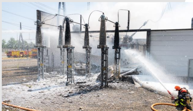
Exemple d'aspersion de mousses et d'eau pour éteindre le feu de transformateur dans une sous-station électrique.
